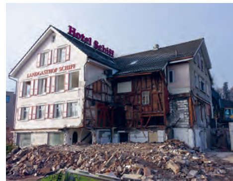
Zum Leidwesen vieler Stammgäste wird derzeit das traditionsreiche Hotel-Restaurant Schiff im Buriet (Gemeinde Thal) abgebrochen.
